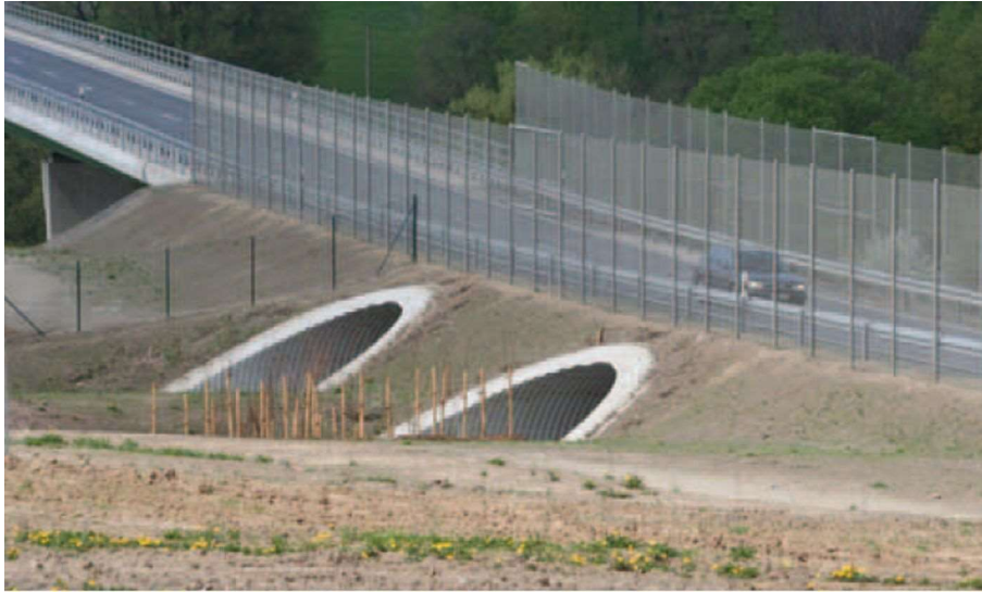
Abbildung 2: Fledermausdurchlässe in Verbindung mit Leitpflanzungen und trassenparallelen 4 m hohen Zäunen mit Leitfunktion an der S 170n nördlich Friedrichswalde-Ottendorf (aus Brinkmann et al. 2012)
