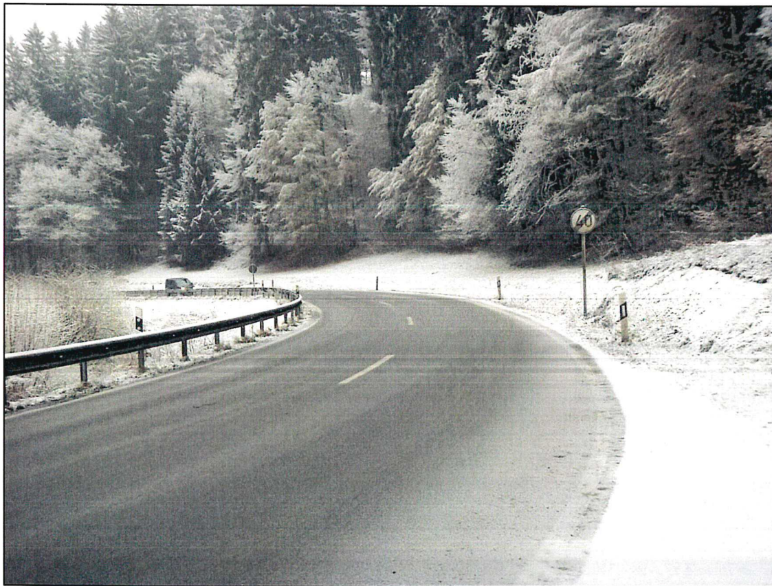
Abbildung 2: Unstetigkeit der Staatsstraße von Bau-km 1+100 bis 1+400
